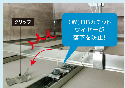
クリップ損傷時
